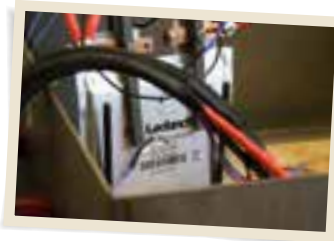
Lithium-Ionen-Batterien für stationäre Anwendungen, die im Projekt TempOLadung untersucht werden
